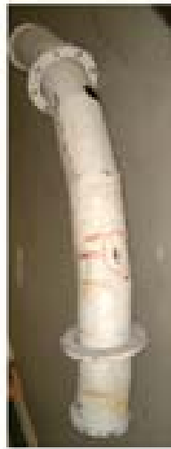
Defekter Rohrbogen DN 80
