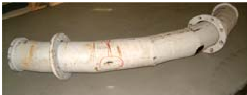
Bild 2: Zerschossener Rohrbogen DN 80, R1000
