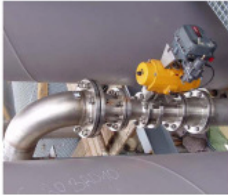
Keramikkugelhahn im Russwassersystem einer Vergasungsanlage
