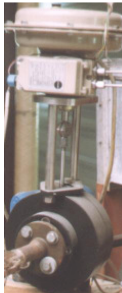
Bild 17: Keramikscheibenschieber in Gipsherstellung
