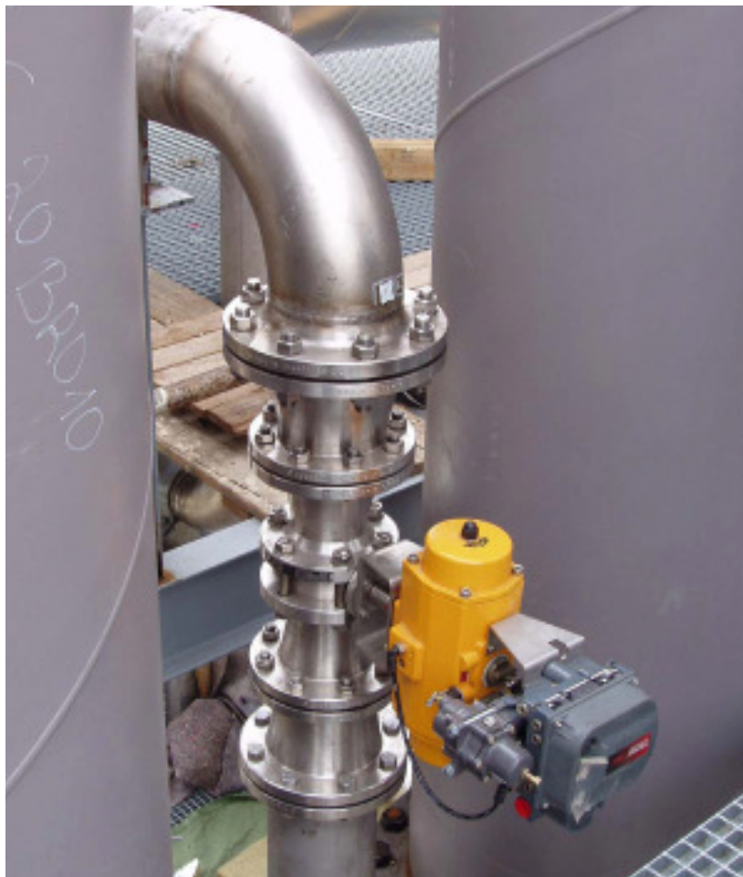
Bild 5: Keramik-Kugelhahn im Russwassersystem einer Vergasungsanlage
