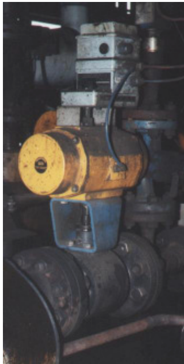
Bild 13: Keramikkugelhahn im Stahlwerk
